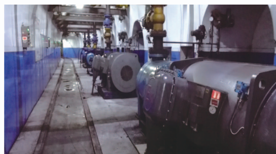
中央水泵房水泵自動化控制系統
