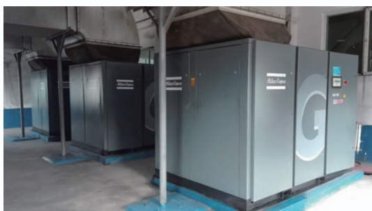
空壓機集控系統
